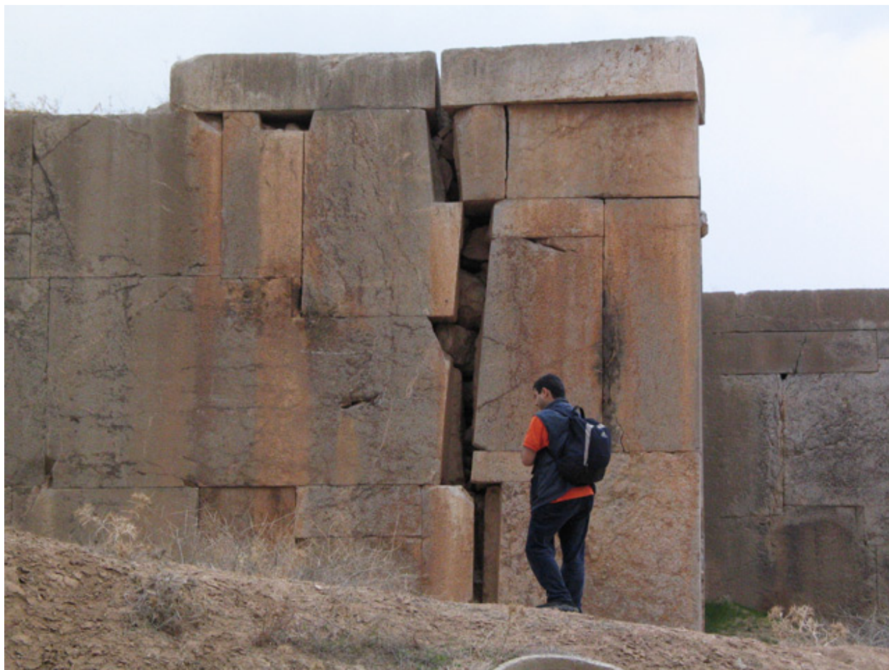
شمال صفه - دیوار در حال تخریب
